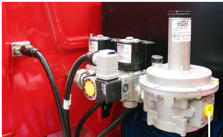
conexión a la red distribución del gas - 1/2"
