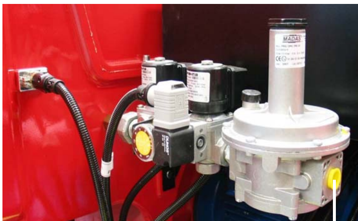
collegamento alla rete distribuzione del gas
