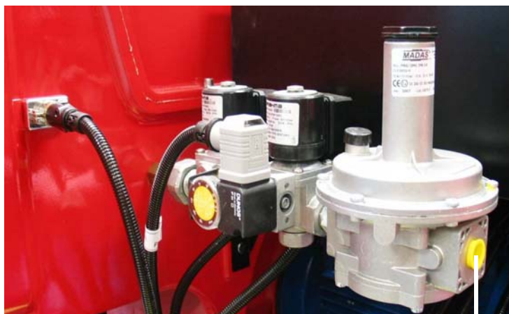
collegamento alla rete distribuzione del gas - 1/2"
